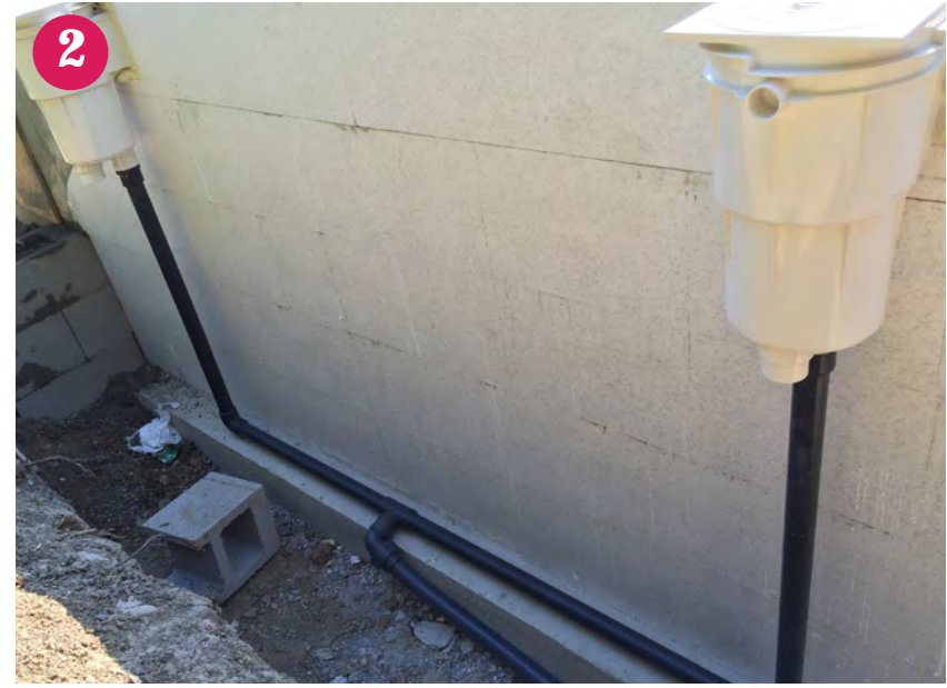
▲ Verrohrung von 2 Skimmer
