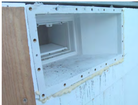
▲ Fertig eingeschäumte WH-Skimmer
